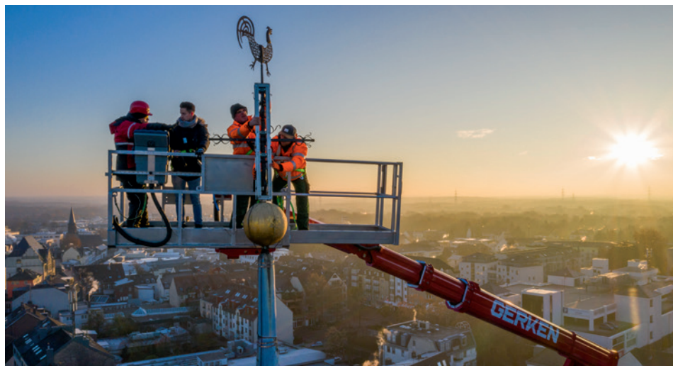
► Große Arbeitskörbe, hohe Hublasten und extreme Reichweiten: 2019 konnte Gerken zahlreiche Einsätze an Kirchtürmen erfolgreich absolvieren. Mithilfe des Powerload-Systems wurden z. B. schwere Stahlteile ohne zusätzlichen Kran montiert.
