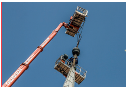
Lemgo: Zwei 75 Meter Giganten vom Typ GL 75 G und H Allrad im Doppelpack. Mit dem Powerlift-System wird das Kreuz demontiert um es zu restaurieren.
